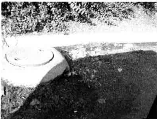
写真-2 市内設置されたセプティックタンク(処理人口1,000人)。施設はこの下にあり、破損配管から漏れ出す汚水が見える。
