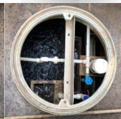
ばっ気槽・沈殿槽・消毒槽
