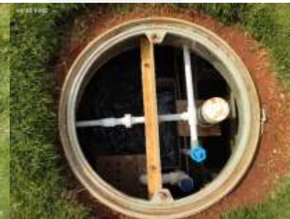
ばっ気槽・沈殿槽・消毒槽
