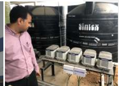
浄化槽ブロワと再生水 貯留タンク
