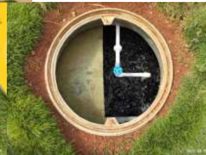
嫌気ろ床槽・ばっ気槽
